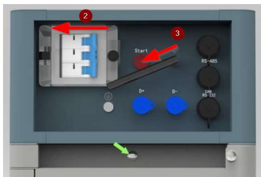
o. č. 2- BMS Pylontech
